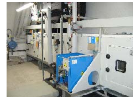
Musikakademie MOD, Klimaanlage Probenraum Altbau
